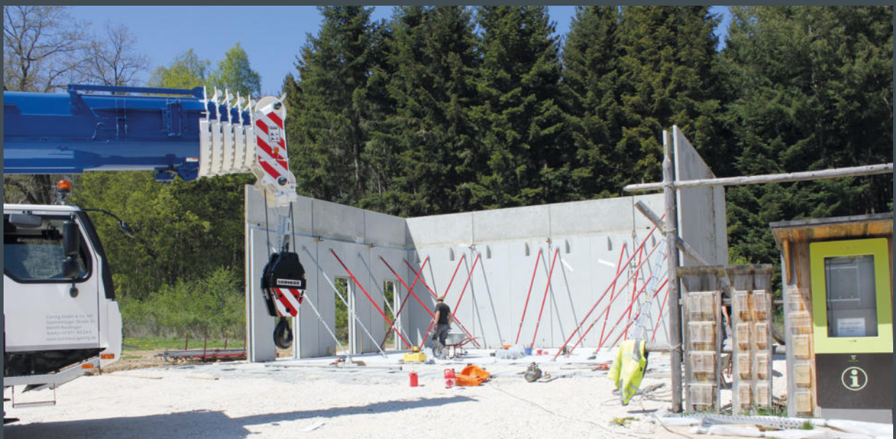
Die höchste Stufe des Recyclings: Demontierbare Betonfertigteile, die an anderer Stelle wieder aufgebaut werden, hier am Beispiel eines Pavillons, der auf der Bundesgartenschau in Heilbronn stand und derzeit in Meßkirch wieder aufgebaut wird.
